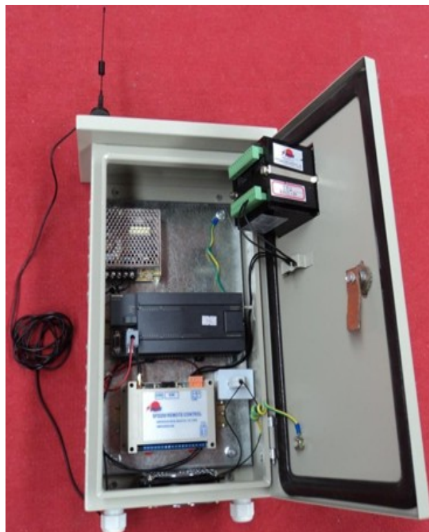
TF2 and TF6 (Substation B)
